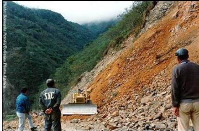
Figura 4. Deslizamiento de tierra en ladera. (Geoenciclopedia)
