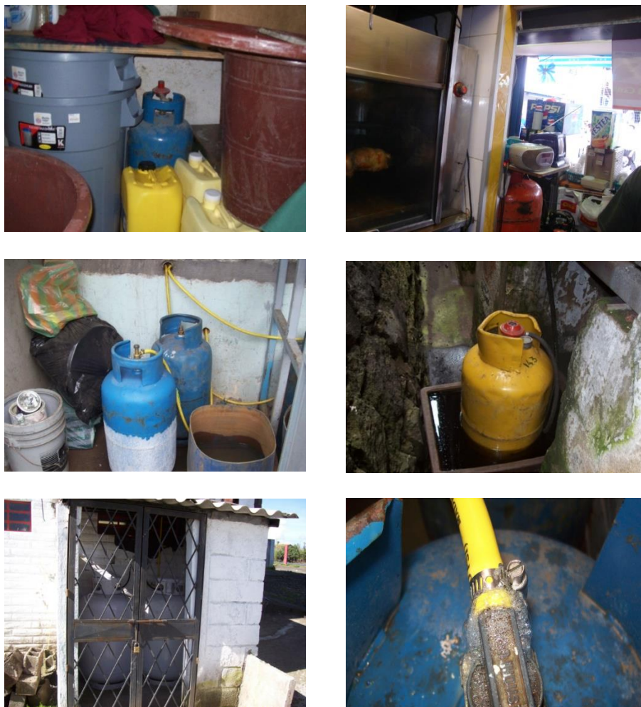
Figura 3: Recipientes de GLP a) cerca de fuentes de ignición b) rodeado de elementos combustibles c) con falta de vaporización d) ubicado en tina con agua caliente e) sin señalización ni elementos de prevención f) con accesorios en mal estado.
